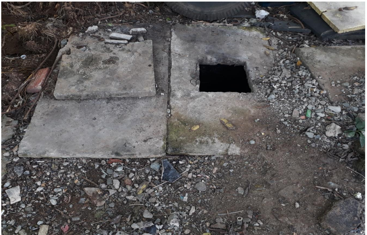
Hình 6: Bể gạt dầu và hố ga tại cửa hàng
