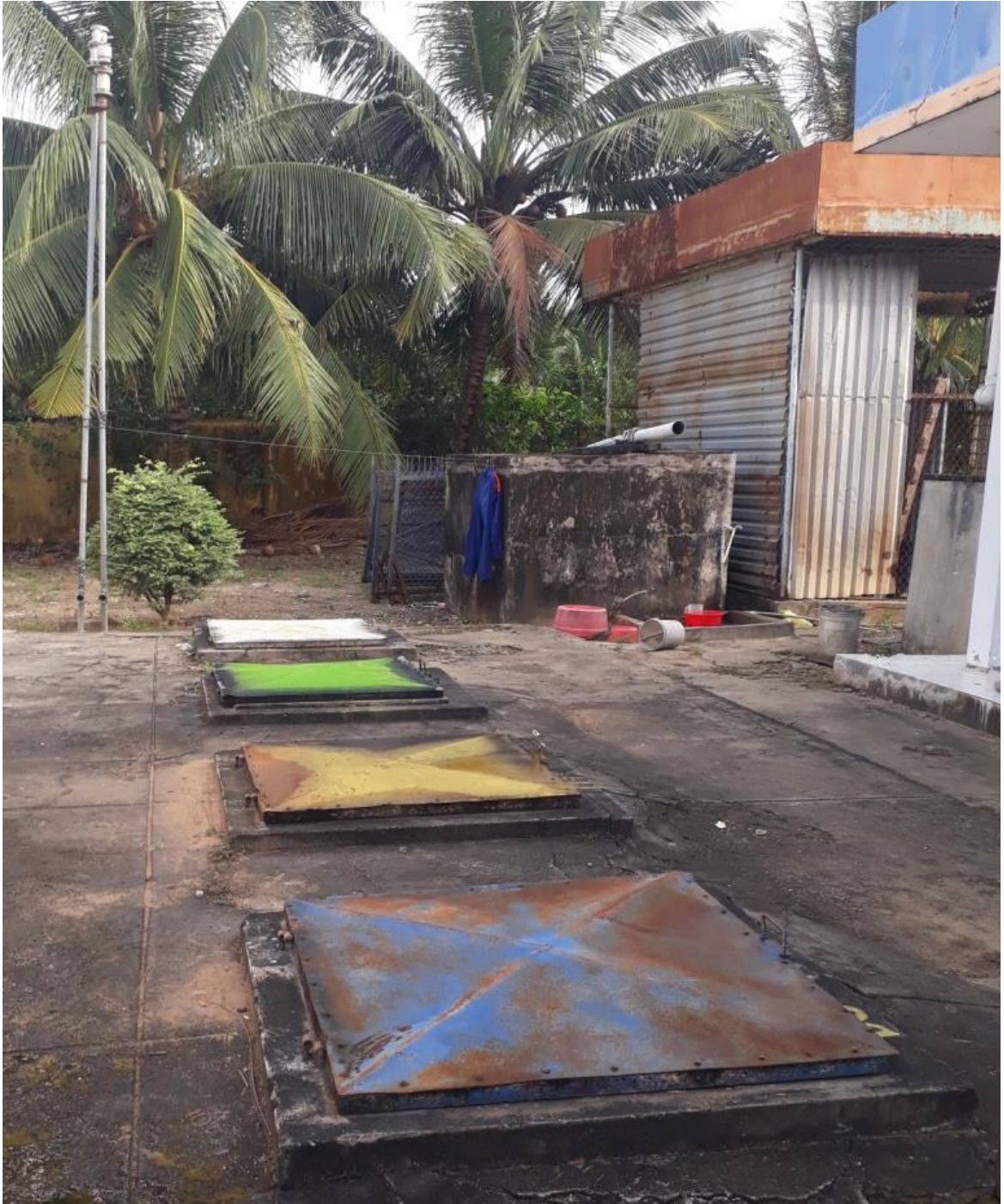
Hình 3: Khu vực bể chứa xăng dầu
