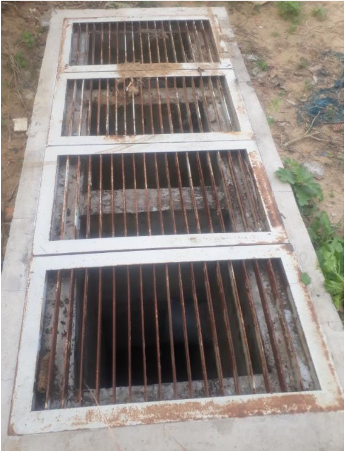
Hình 5: Bể gạn dầu và hố ga tại cửa hàng
