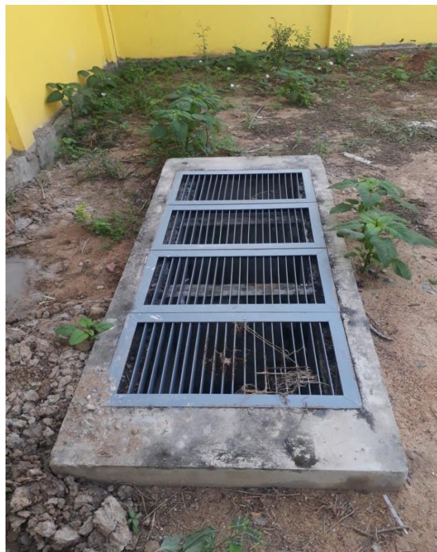
Hình 6: Bể gạn dầu và hố ga tại cửa hàng
