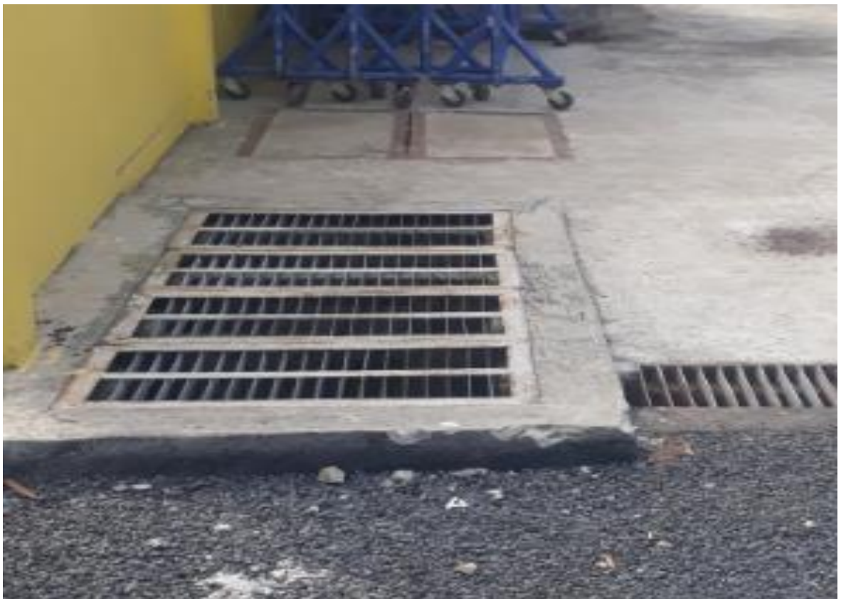
Hình 5: Bể gạn dầu và hố ga tại cửa hàng
