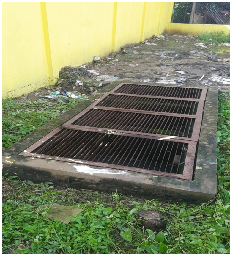
Hình 6: Bể gạn dầu và hố ga tại cửa hàng
