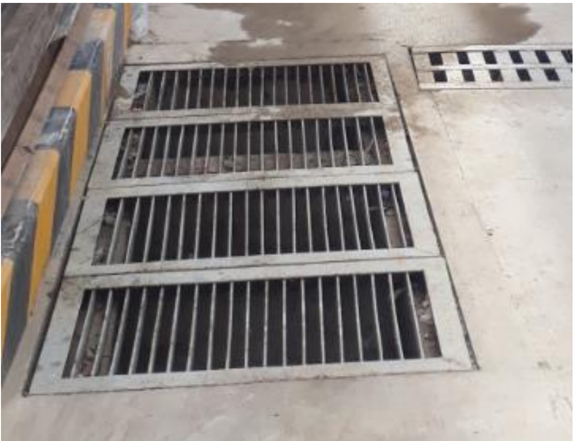
Hình 5: Bể gạn dầu và hố ga tại cửa hàng
