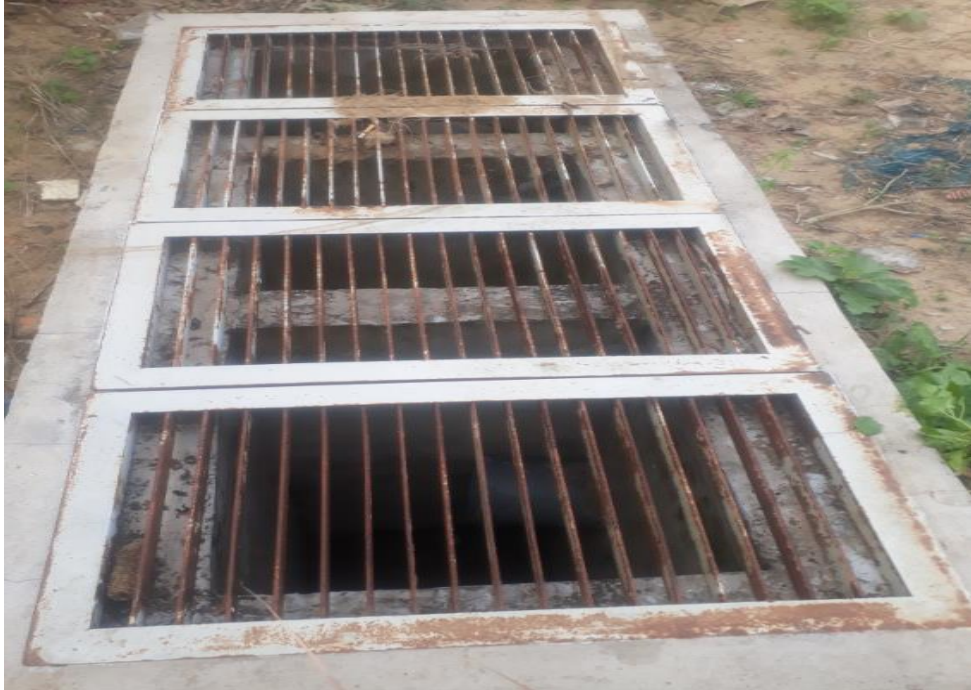
Hình 6: Bể gạn dầu và hố ga tại cửa hàng
