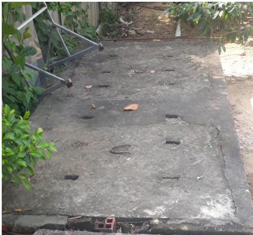
Hình 5: Bể gạn dầu và hố ga tại cửa hàng
