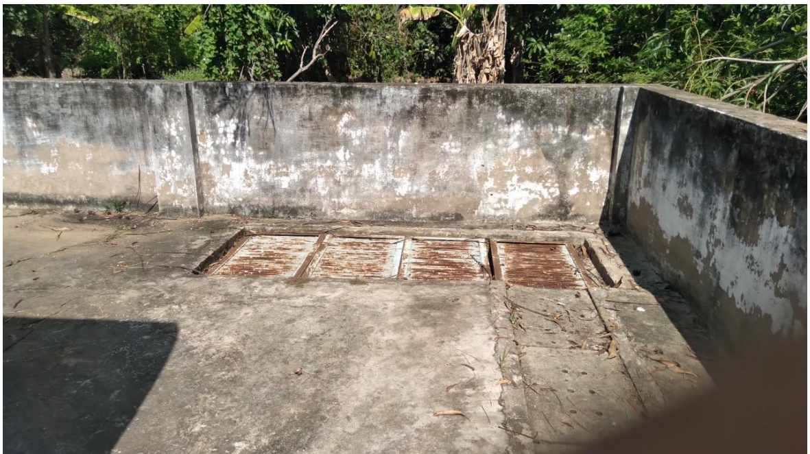
Hình 6: Bể gạn dầu và hố ga tại cửa hàng
