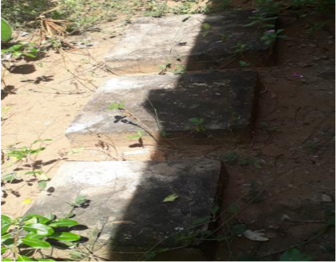
Hình 5: Bể gạt dầu và hố ga tại cửa hàng
